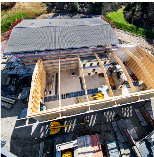
Heizzentrale Wärmeverbund Sarnen
